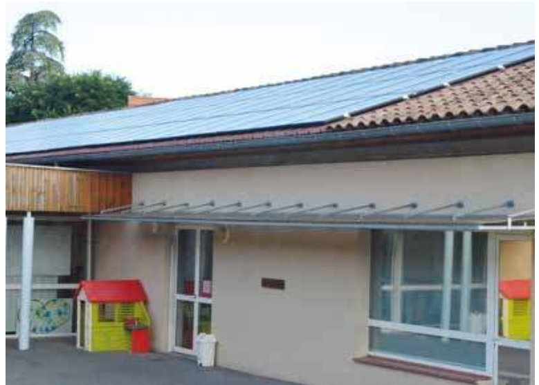
Panneaux photovoltaïques école de Cahuzac
